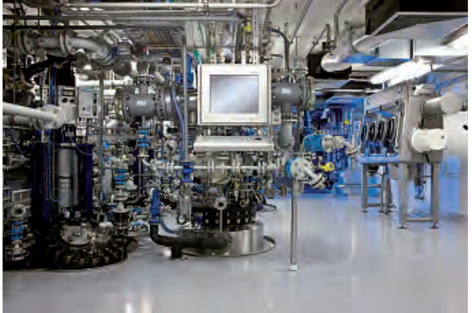
VisuNet Zone 1 PC in der Pharmaproduktion, basierend auf der chemischen Synthese von Wirkstoffen. Panel-PC im Edelstahl Feldgehäuse, Einsatz in der ATEX Zone 1, mit Tastatur und Maus, direkt an vorhandenen Trägern der Anlage montiert. Darstellung der Anlagensteuerung auf Basis eines SCADA Systems als Client in einer Client-Server Netzwerk Architektur für die Produktion.
