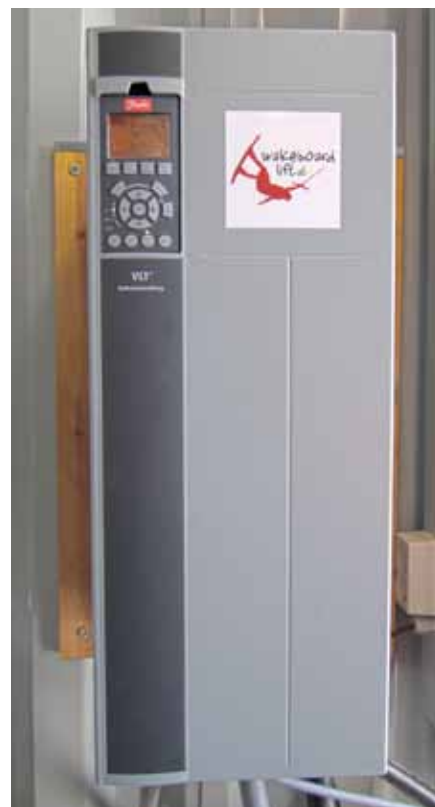
Mit dem Frequenzrichter lässt sich der Motor optimal an die aktuelle Auslastung der Bahn anpassen. Dadurch senkt er die Energiekosten der Seilbahnanlage.
