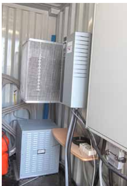
Aktueller Einblick in den Technikraum.
