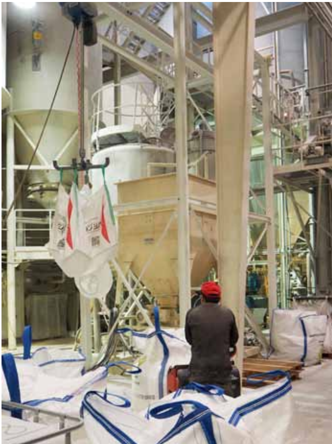
BigBag Entleeranlage mit integriertem Portalkran in industrieller Anwendung. Nach der Entleerung werden die Chemikalien pneumatisch in ein Tagessilo gefördert.
