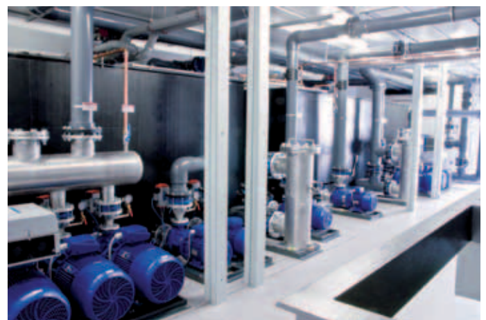
L&R Kälteanlage für Moens Mouldings B.V., Beverwijk (NL): Je eine der drei Betriebspumpen für den Werkzeug- und Hydraulikkreislauf ist mit einer elektronischen Drehzahlregelung ausgestattet. Das sichert die exakte Anpassung der Pumpenleistung an den aktuellen Bedarf.
