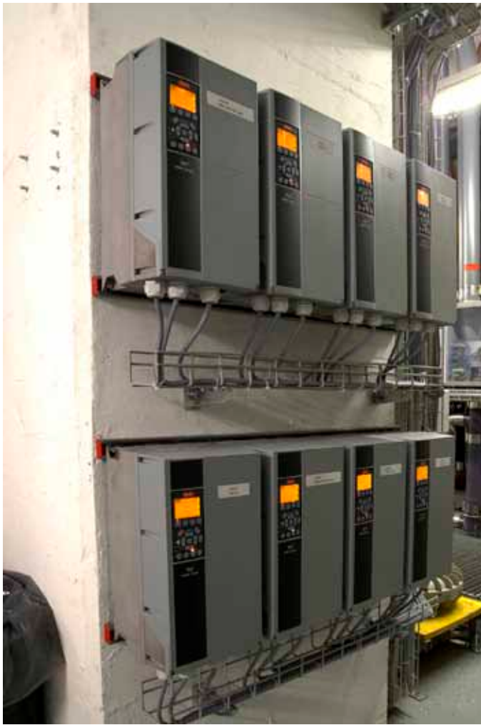
Danfoss Frequenzumrichter der VLT® HVAC Drive Serie im Einsatz. Das gesamte Rohrleitungsnetz hat inzwischen eine Länge von mehr als 30 Kilometern erreicht.
