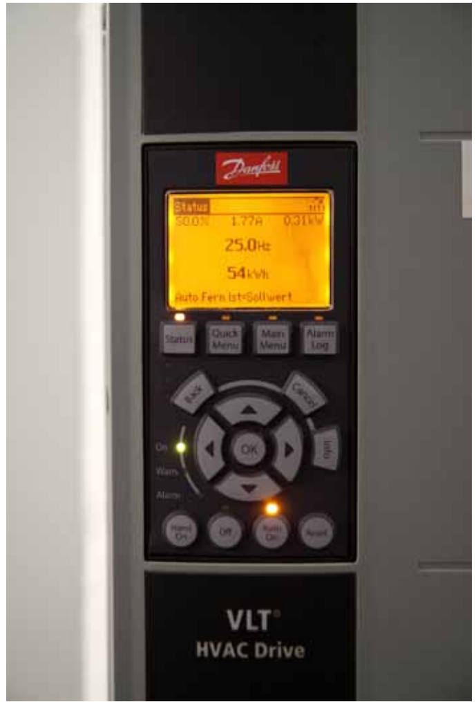
Die Drehzahlregelung ersetzt die bis dahin eingesetzte Drosselregelung. Dies führt zu einer erheblichen Senkung der Energiekosten.
