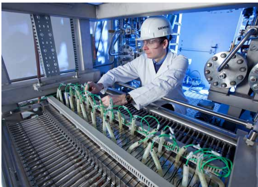
PEM-Technologie (Proton Exchange Membrane) als Herzstück einer der weltweit größten Elektrolyseanlagen.
