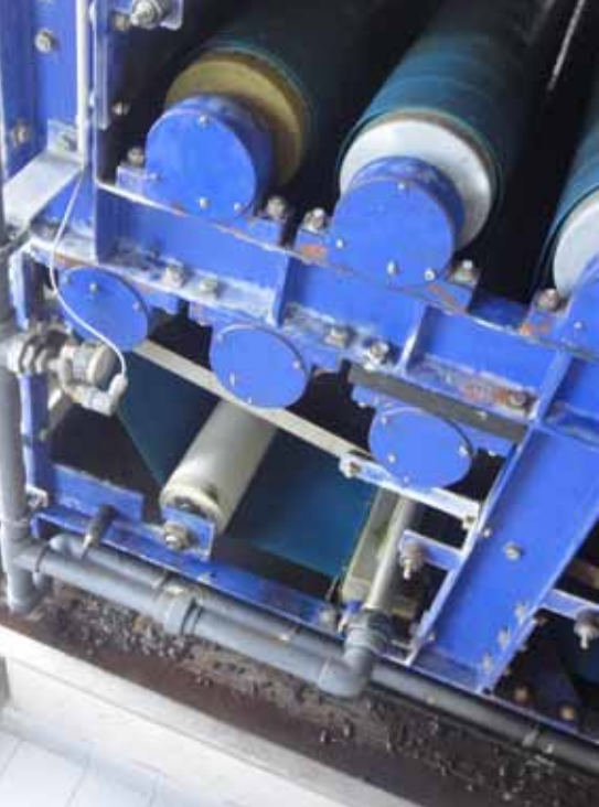
Im Pressbereich durchläuft der Schlamm zwischen Ober- und Untergurt mit 8 bar Bandspannung elf Walzen des Walzenregisters.
