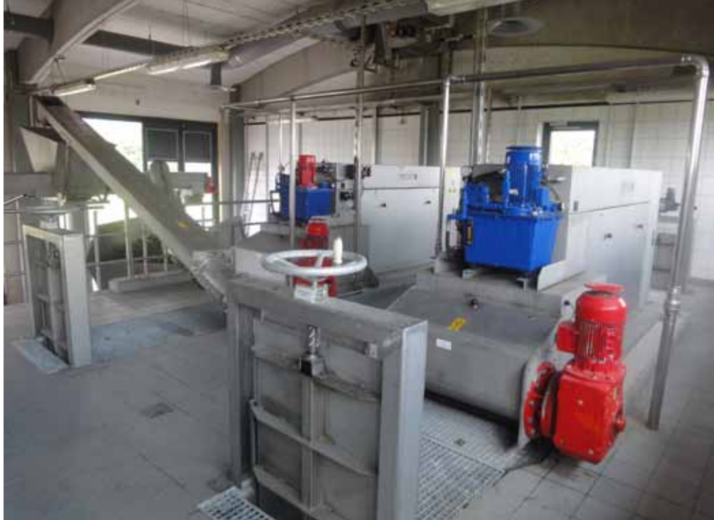
Die mechanische Reinigung erfolgt über eine Rechenanlage mit Schneckenpresse zur Rechengutentwässerung.
