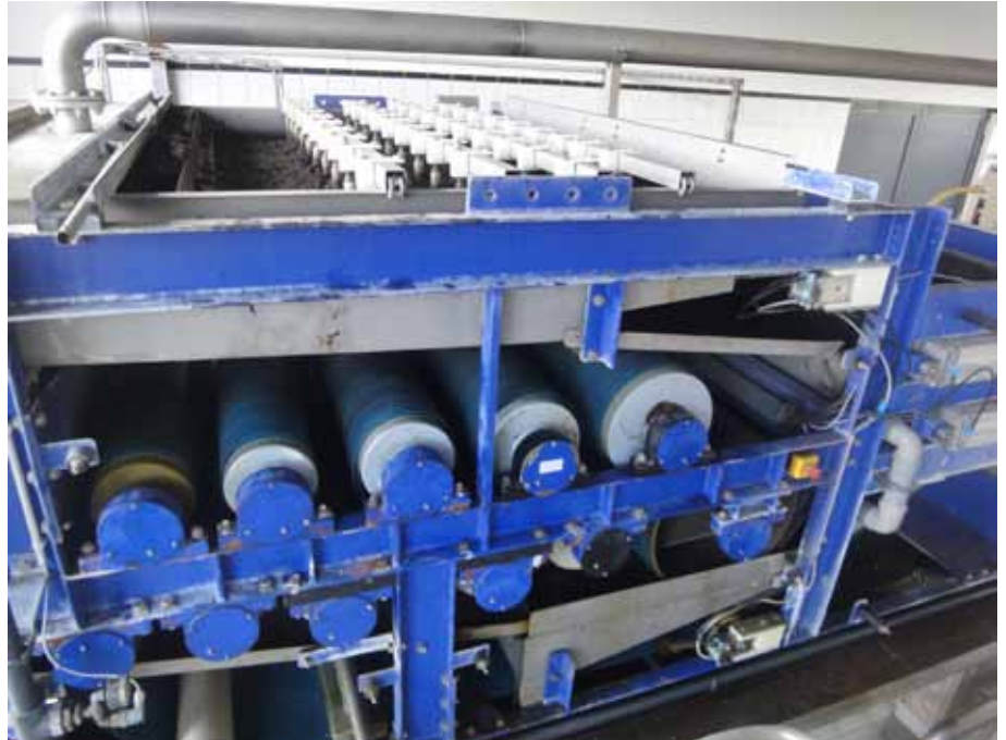
Die Siebbandpresse wird direkt vom Eindicker aus beschickt, sodass etwa 160 Kubikmeter Schlamm pro Betriebstag entwässert werden.
