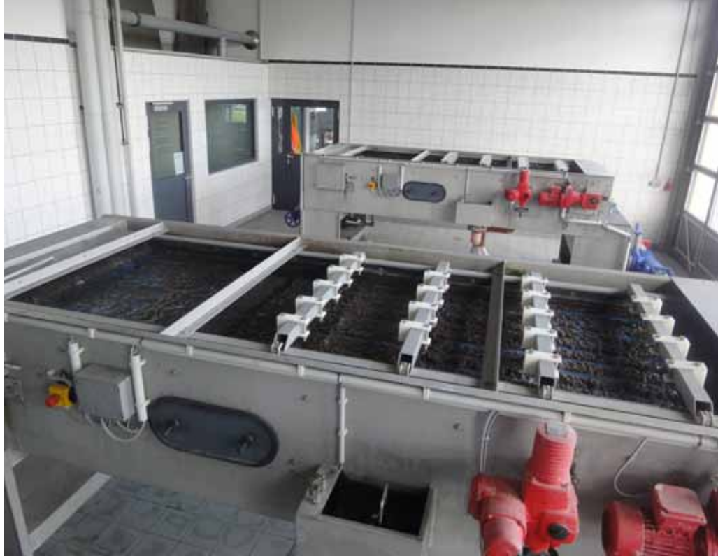
In zwei Bandeindickern wird der Feststoffgehalt des Überschussschlammes mit endlos umlaufenden GKD-Siebbändern vom Typ 5060 unter Zugabe von Flockungsmittel von 3 auf etwa 5 % TS erhöht.
